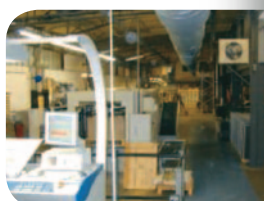
Nouveau système de climatisation, Intérieur.
