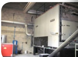
Chaudière à paille
