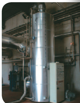
Nouveau système de production d'eau chaude
