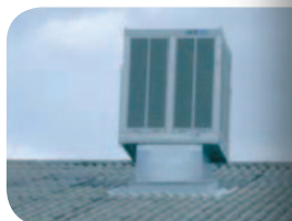
Nouveau système de climatisation, Intérieur.
