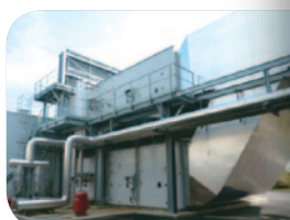
Récupérateur de chaleur, vue arrière
