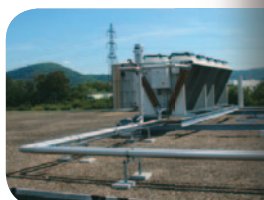
Dry Cooler en toiture
