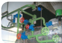
En noir, l'économiseur installé en sortie de chaudière
