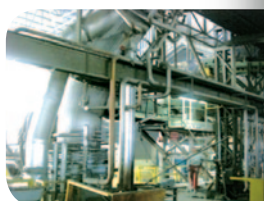
Système de séchage des tournures installé
