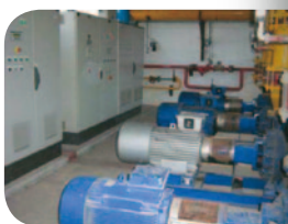
Moteurs électriques des 4 pompes à eau
