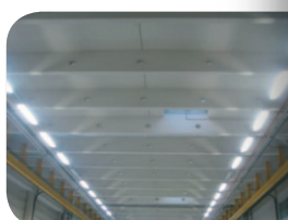
Nouvel éclairage de l'atelier
