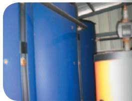
Réservoirs d'eau chaude
