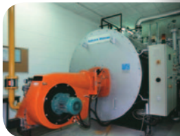
Système de mise en chauffe de l'appareil de production
