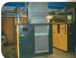
Compresseurs T/R de 90kW
